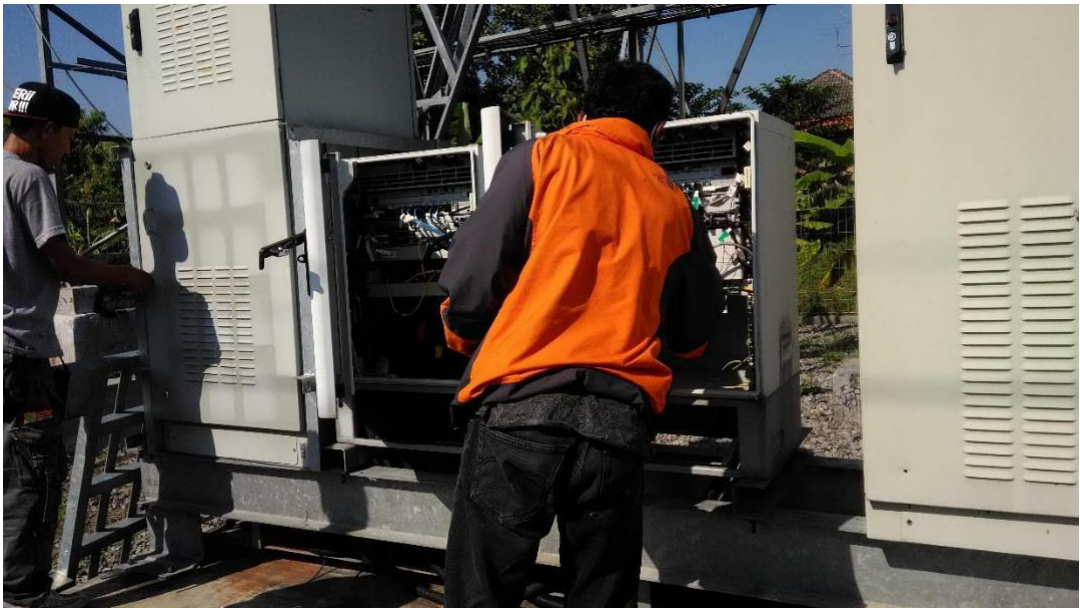
Pengecekan Kabel Jaringan
